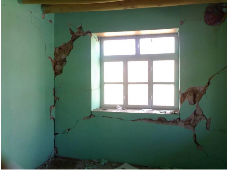
Resim 3.8. Yığma Duvarda Geniş ve Eğik Çatlaklar (Bu çatlaklar binanın her iki cephesinde de yoğun şekilde devam ettiğinden taş bina ağır derecede hasarlıdır.)
