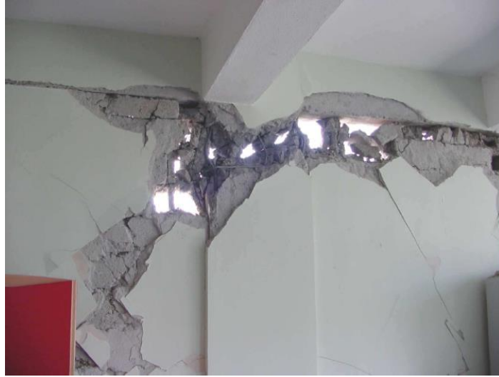
Resim 3.15. Kolon Donatılarında Burkulma (Ağır Hasar)
