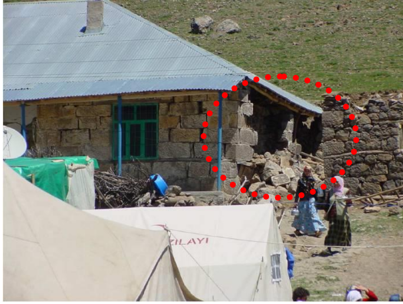
Resim 3.10. Taş Binada Duvar Devrilmesi ve Köşe Birleşiminde Hasar
