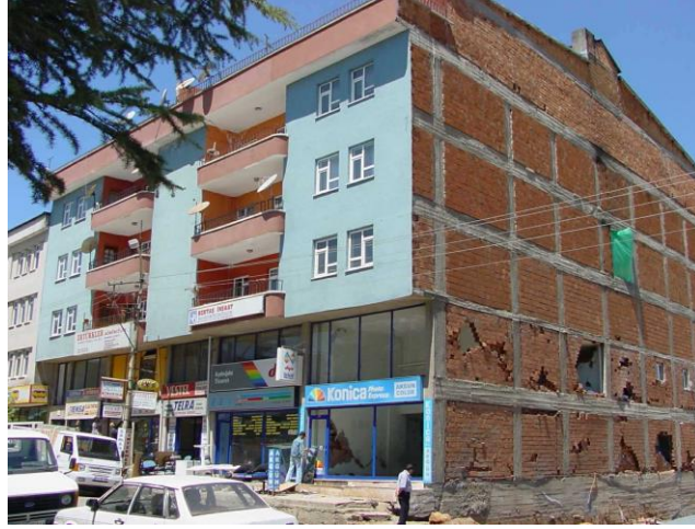
Resim 3.12. Dolgu Duvarları Hasarlı, Taşıyıcı Sistemi Sağlam Bir Bina (Sistem Hasarı Az)
