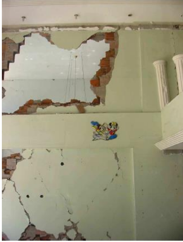
Resim 3.13. Dolgu Duvarda Ağır Hasar Ancak Binada Az Hasar
