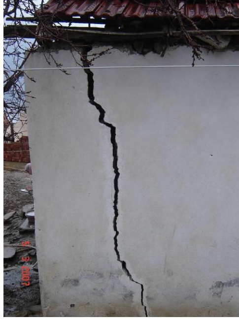
Resim 3.5. Yetersiz Rijitlikte Bir Çatı Sistemi İle Bağlanmış Duvarda Meydana Gelen Hasar
