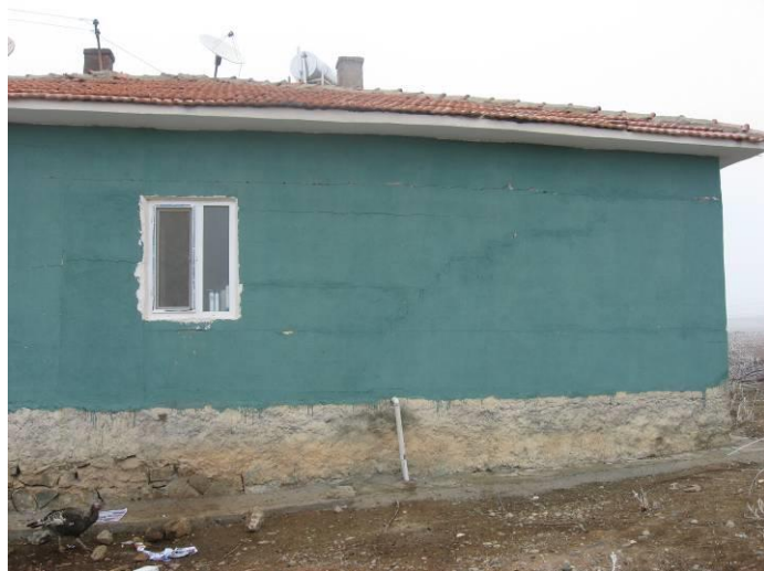
Resim 3.2. Yığma Binada Hatıl Hizasında İnce Çatlaklar
