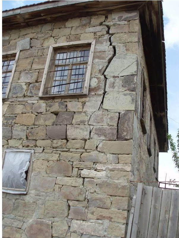
Resim 3.6. Taş Binada Üst Kat Duvarında Meydana Gelen Kenar Açılması
