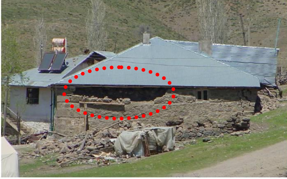
Resim 3.7. Kısmi Düzlem Dışına Duvar Devrilmesi
