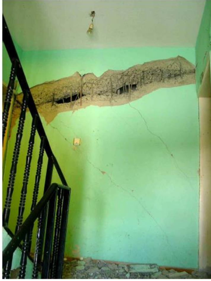
Resim 3.18. Perde Duvarda Ağır Hasar
