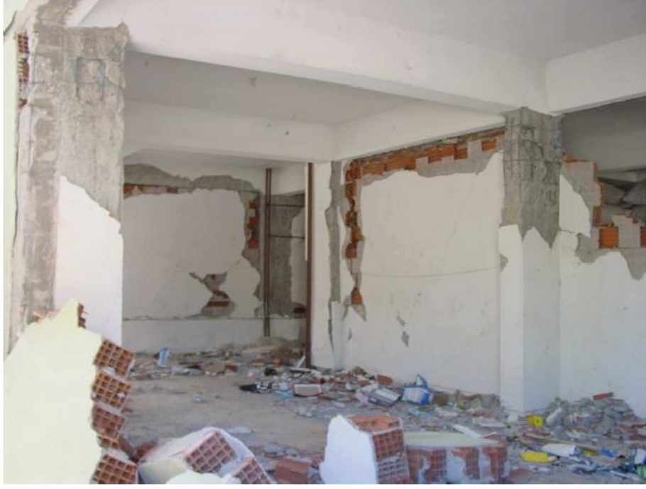
Resim 3.14. Kolonlarda Betonda Ezilme ve Dökülme (Sistem Hasarı Orta Hasar)
