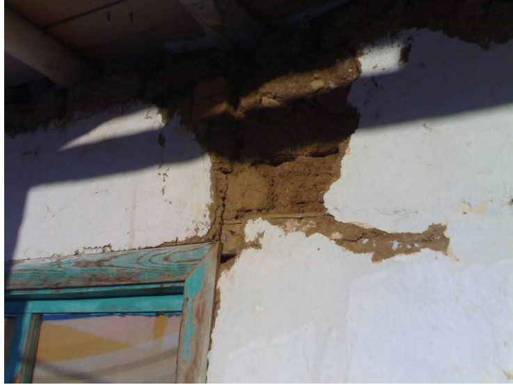
Resim 3.3. Kerpiç Binada Sıva Dökülmesi
