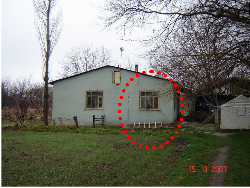
Resim 3.1. Pencere Boşluğu Kenarında Eğik Çatlaklar (Binada bu cephede gözlenen çatlaklar dışında hasar bulunmadığından, bina az derecede hasarlıdır.)
