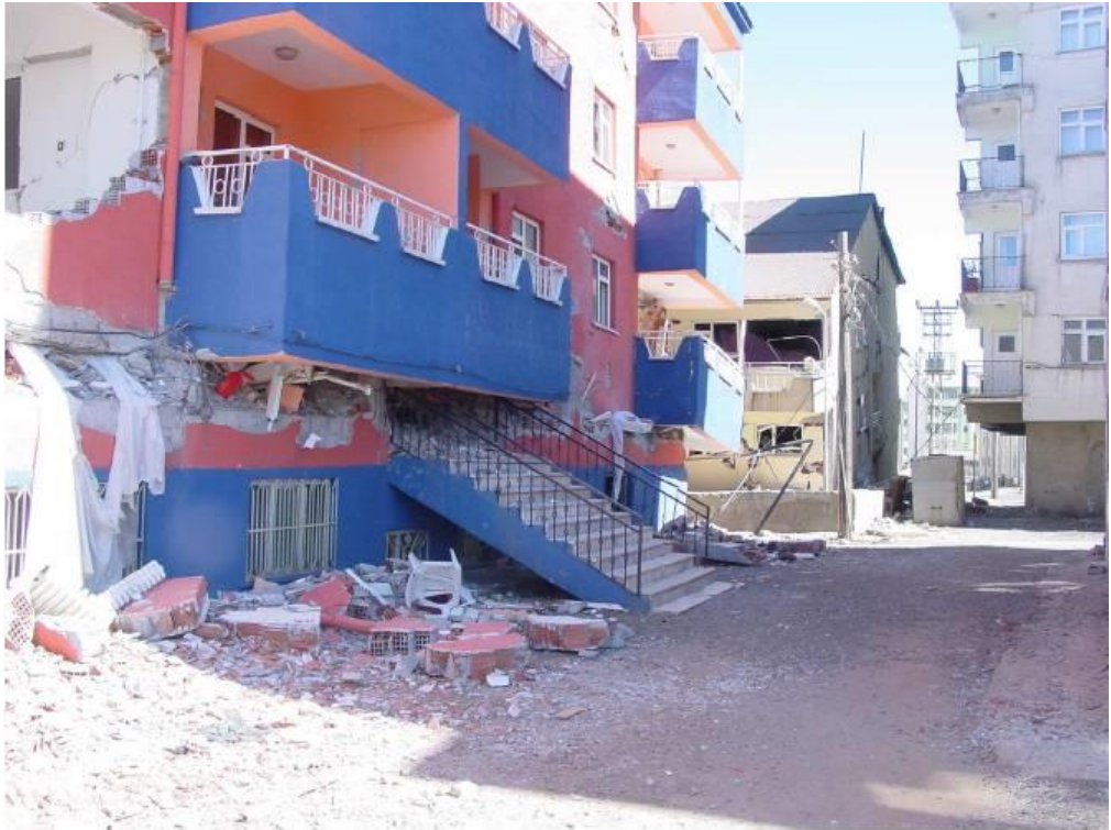
Resim 3.17. Yumuşak Kat Göçmesi (Yıkık)
